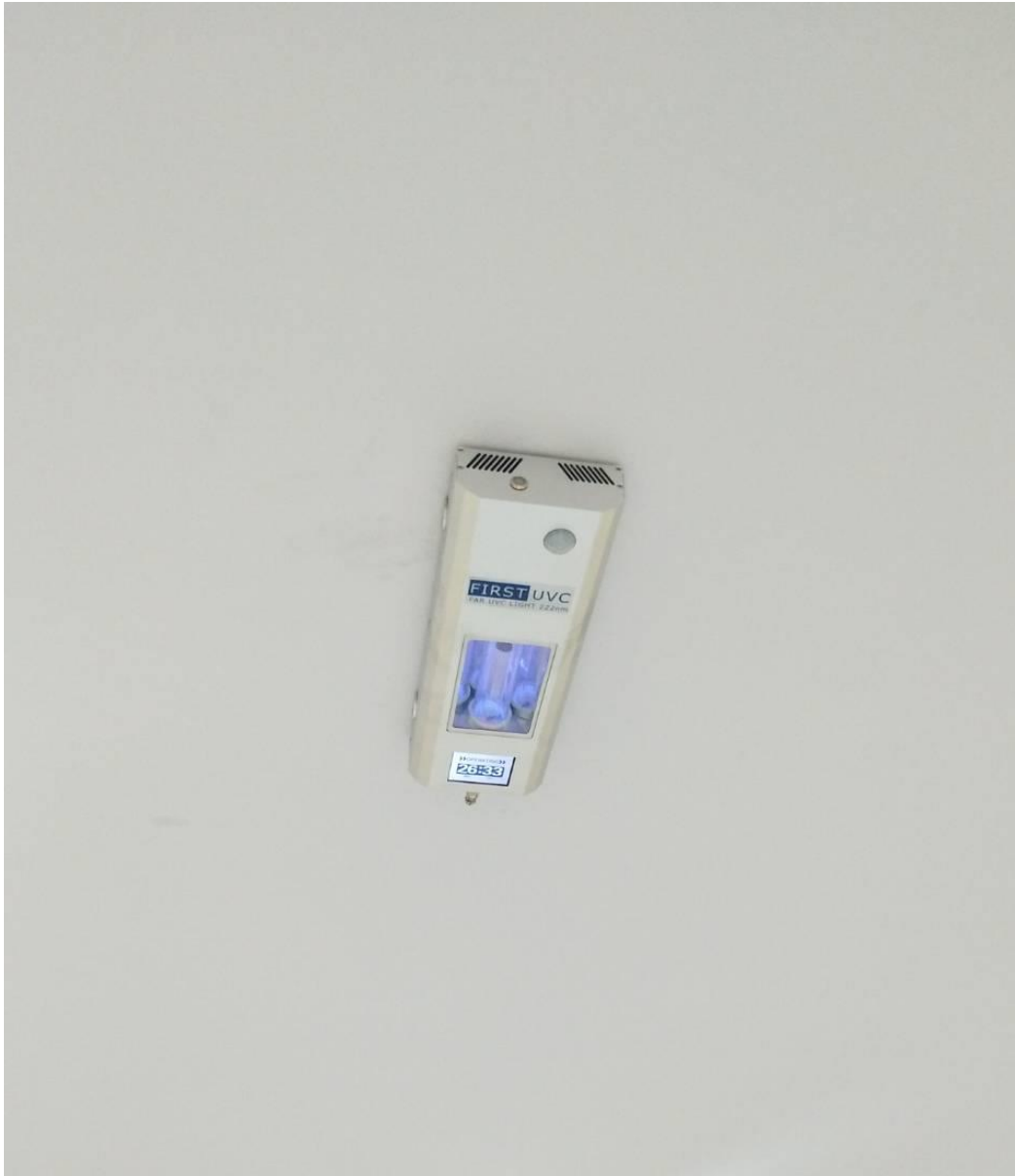
รูปที่ 3 ติดตั้งโคมไฟเอกไซเมอร์ UV-C ไว้บนเพดานกลางห้อง สูงจากพื้นห้อง 2.4 เมตร (เปิดปิดโดย Remote control)
